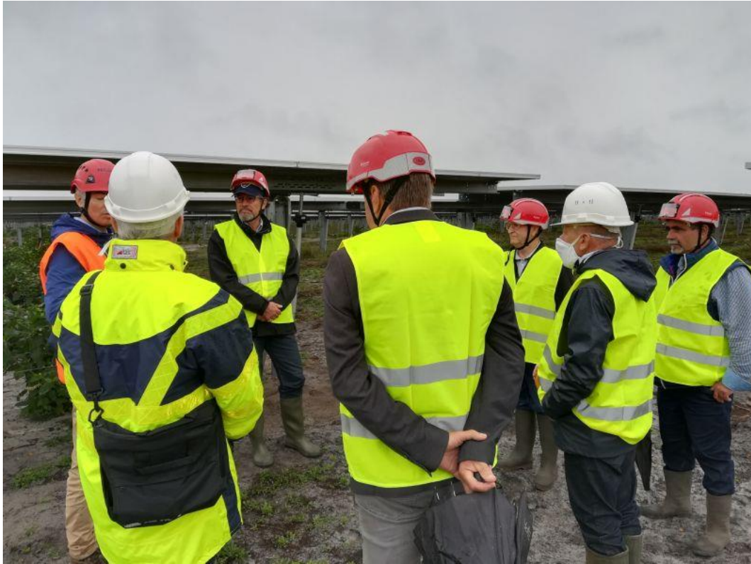
Visite du conseil d'administration au chantier de la centrale solaire de Réaup-Lisse (sept 2020)
