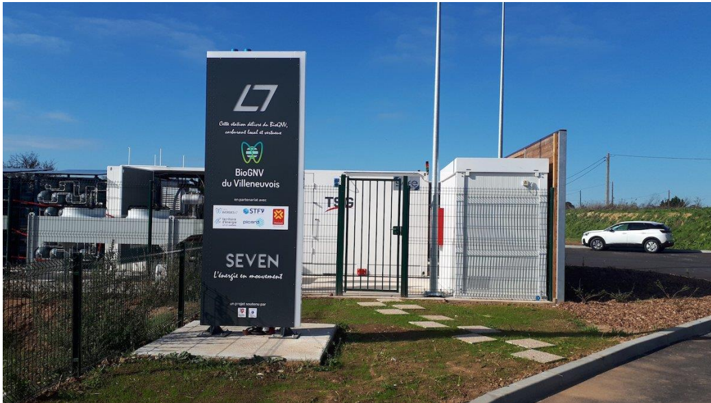
Station BioGNV du Villeneuvois
