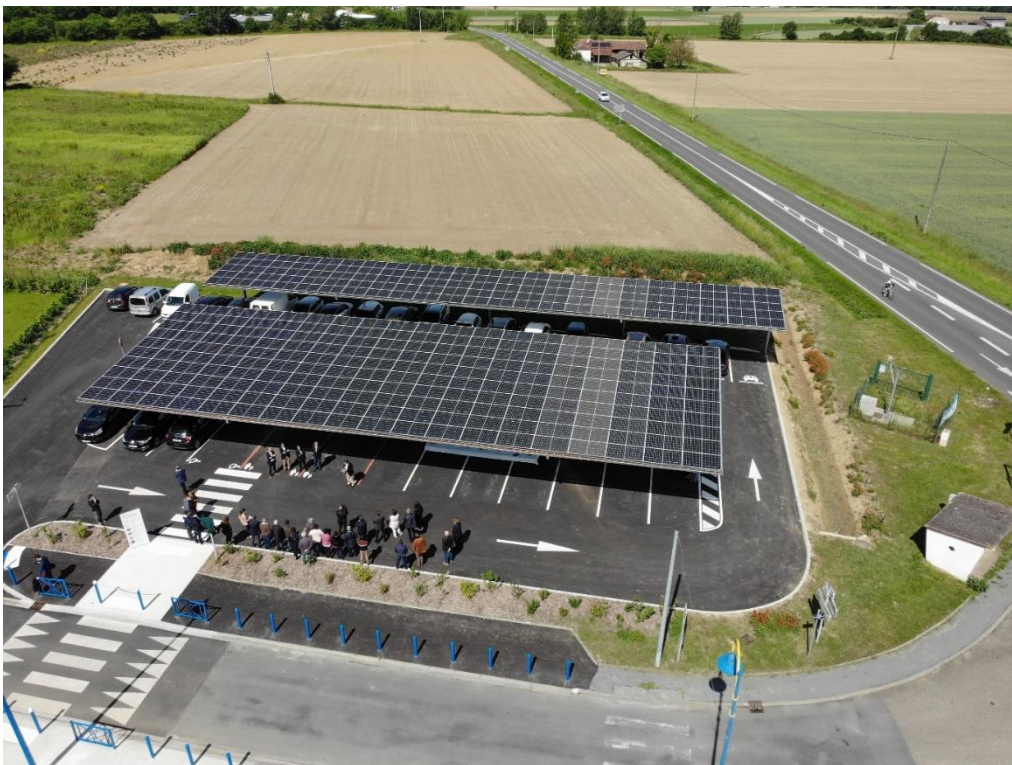
Ombrière solaire de Montesquieu (47)
