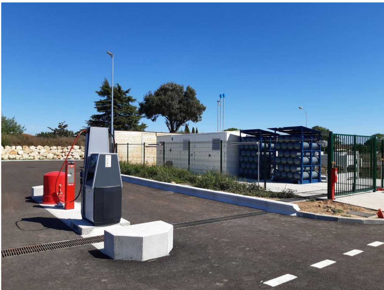
Station BioGNV du Villeneuvois, à Villeneuve-sur-Lot (47 300). Source : SEVEN
